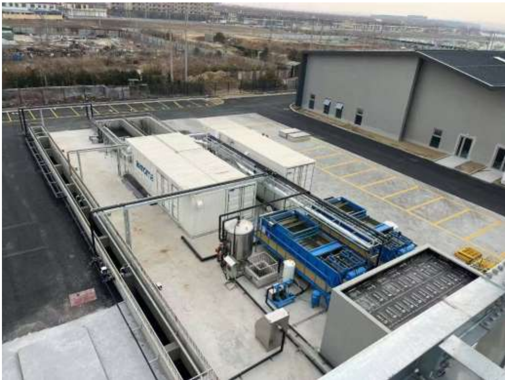
〈某新材料有限公司紡絲廢水處理案件〉
